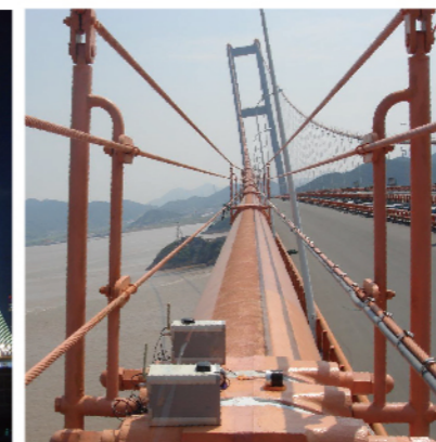
大跨径桥梁无线振动测试系统
